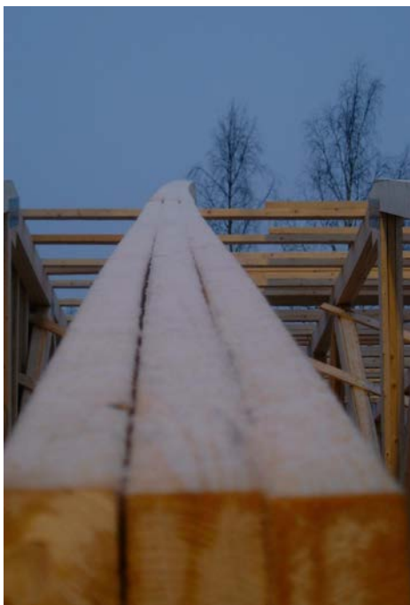
Kuva 1 Alkukäyryydet ja -vinoudet on mahdollista havaita asennusvaiheessa.
