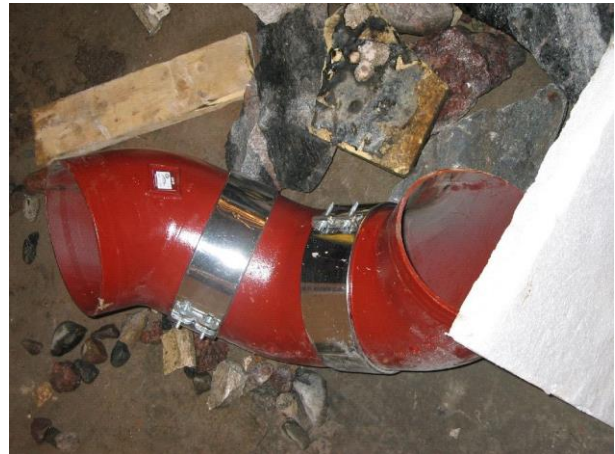
Kuva 2 Irronneet kulmakappaleet lattialla.
