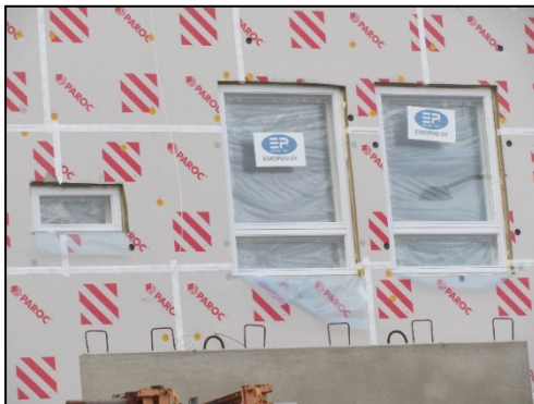
Kuva 1. Tästä seinästä puuttuu vielä tuulensuojalevyn päätyreunojen suojaukset ikkunaukkojen liittymissä.
