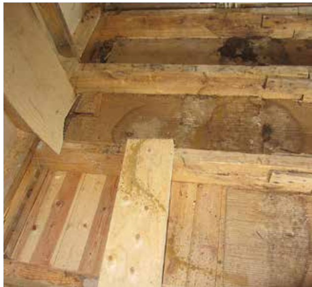
Pientalon puuvälipohjan kosteusvaurio näkyy avatussa rakenteessa.
