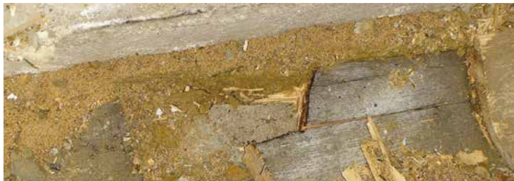
Ulkoseinän vaurioitunutta alaosaa. Betonissa kiinni oleva puu on kärsinyt kosteudesta.
