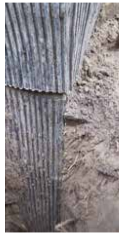
Rakennuksen perusmuuri-levy on asennettu virheellisesti, jolloin kosteus pääsee rakenteisiin.
