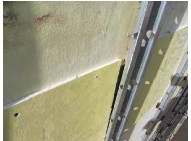
Virheellisesti asennettu tuulensuojalevy päästää sadeveden rakenteen sisälle.
