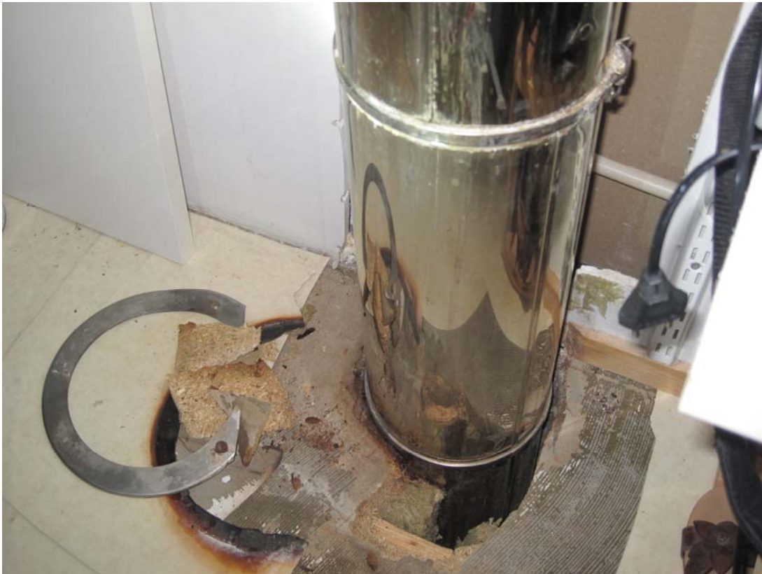
Kuva 1. Välipohjan läpi kulkevan savupiipun virheellisen asennuksen aiheuttamia vaurioita.
