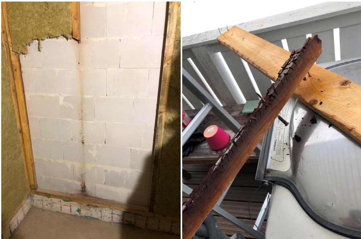
Kuva 1. Vasemmalla purettua seinärakennetta saunan puolelta kuvattuna, oikealla puretut vaurioituneet seinän koolauspuit.
