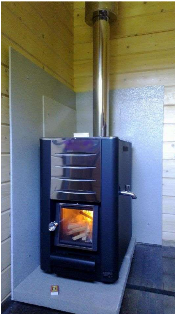
Kuva 1. Kiukaan ja yhdysputken virheellinen asennus.
