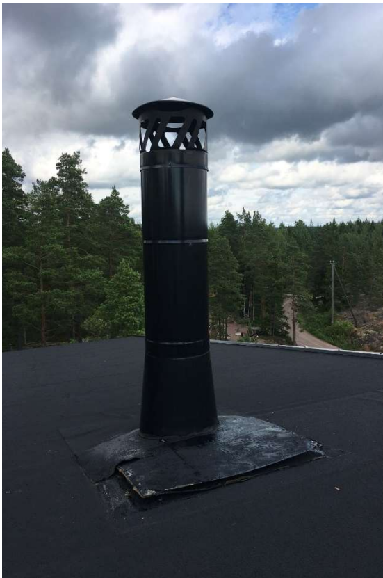
Kuva 1. Hirsitaloon virheellisesti asennettu savupiippu.
