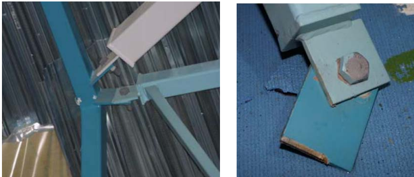
Kuva 6. Taipunut kiinnityskorvake ja irti repeytynyt ristikko sekä korvake (kuvat: B1/2003Y, OTKES).
