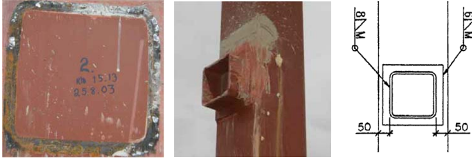
Kuva 5. Hitsisauman tunkeuma pilariin, ehjä konsoli ja konsolin kiinnityshitsaus (kuvat: B3/2003Y, OTKES).
