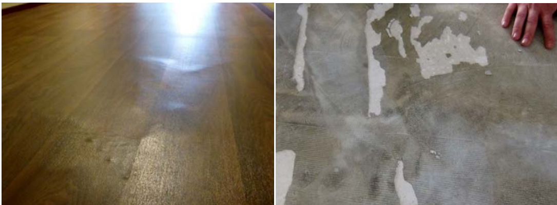
Kuvat 1 ja 2. Kupruja käytävällä ja silmännähtäviä vaurioihin viittaavia muutoksia maton alla. Tasoite on lähtenyt paikoin maton mukana, koska sementtiliimaa ei ollut poistettu kunnolla.
