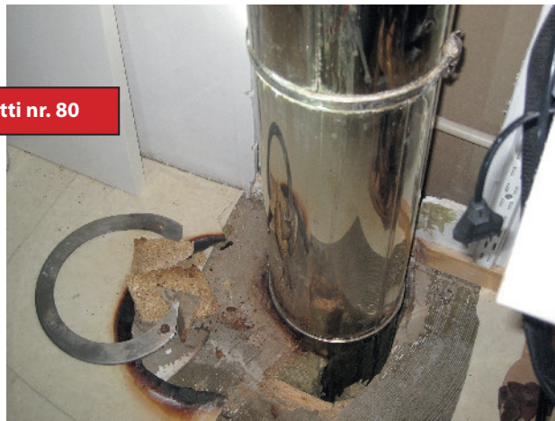
Välipohjan läpi kulkevan savupiipun virheellisen asennuksen aiheuttamia vaurioita.
